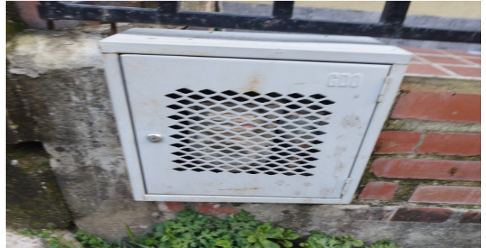
Contador de Gas
