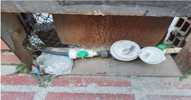
Contador de Agua
