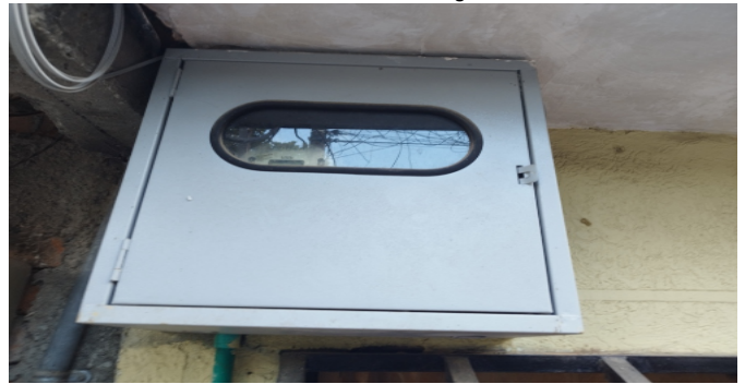
Contador de Energia
