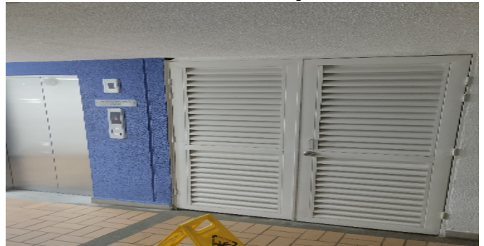
Contador de Energia
