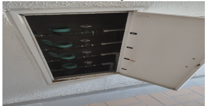
Contador de Agua
