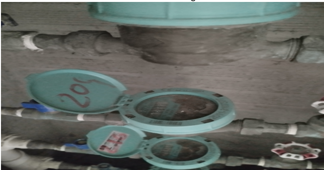
Contador de Agua
