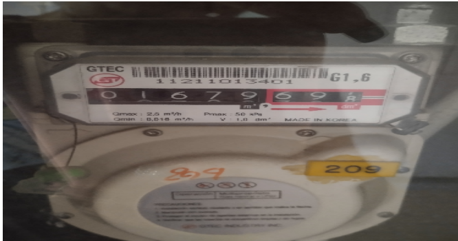
Contador de Gas
