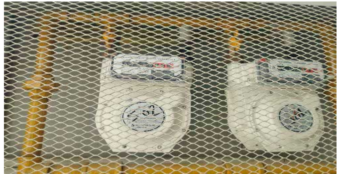
Contador de Gas
