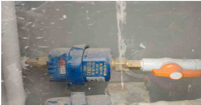
Contador de Agua
