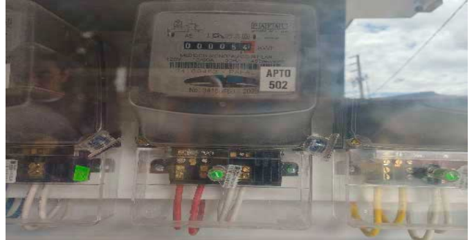
Contador de Energia
