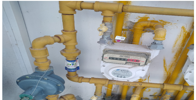
Contador de Gas
