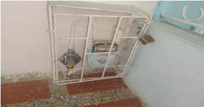
Contador de Gas
