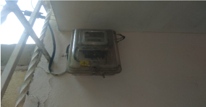
Contador de Energia
