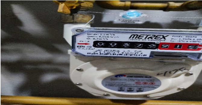
Contador de Gas
