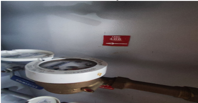
Contador de Agua
