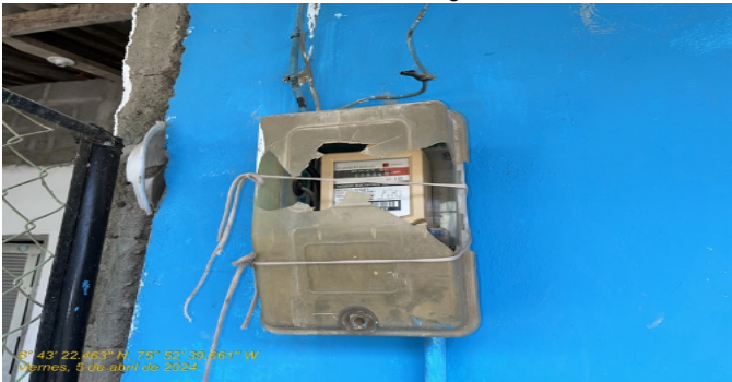
Contador de Energia
