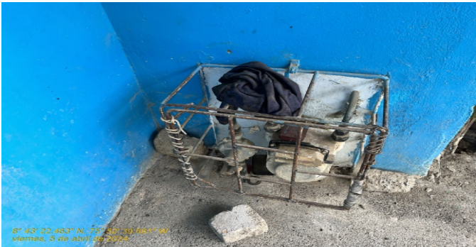
Contador de Gas
