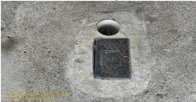
Contador de Agua
