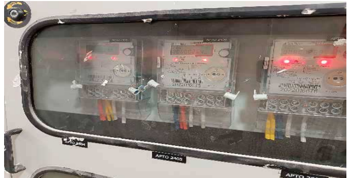
Contador de Energia
