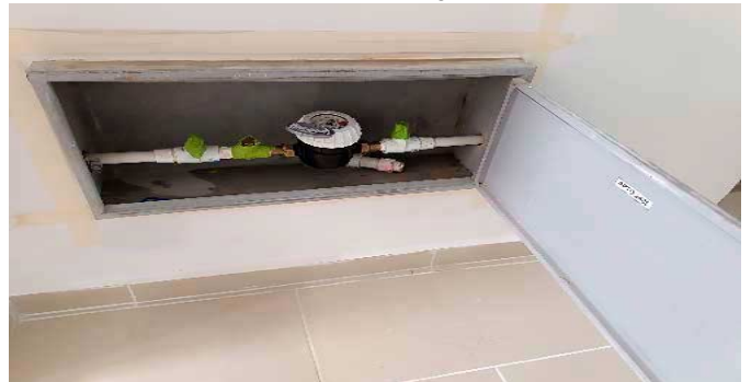
Contador de Agua
