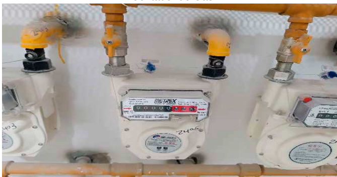
Contador de Gas
