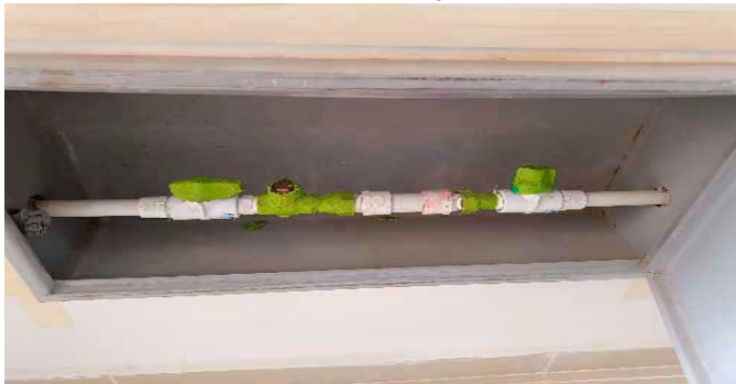
Contador de Agua
