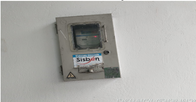
Contador de Energia
