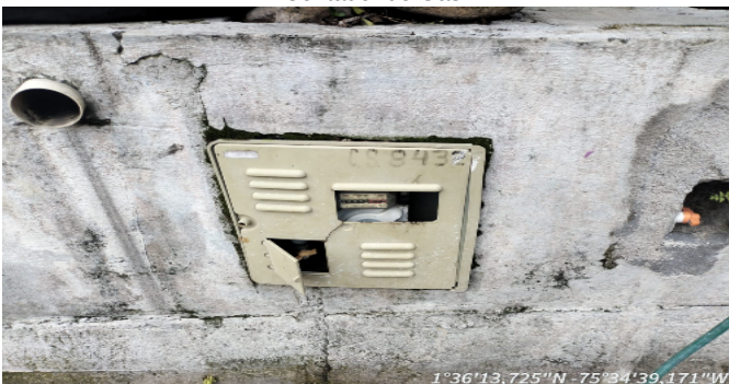
Contador de Gas
