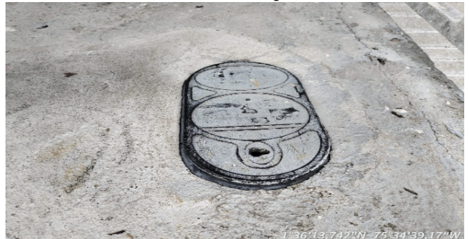
Contador de Agua
