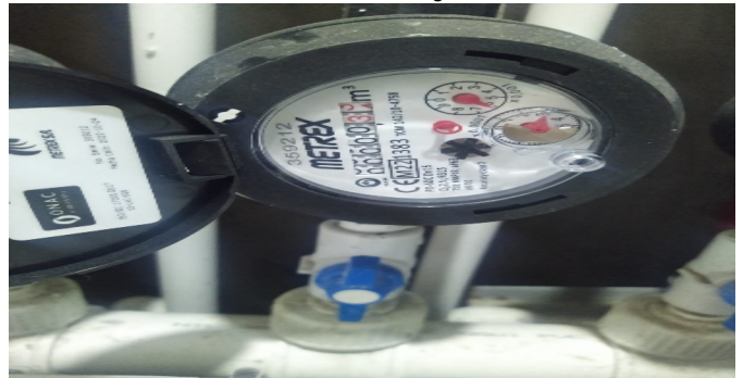
Contador de Agua
