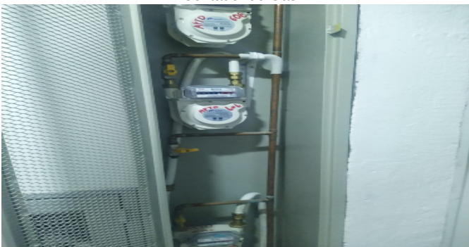
Contador de Gas
