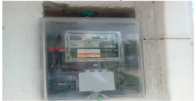
Contador de Energia
