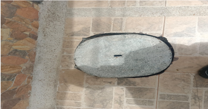
Contador de Agua
