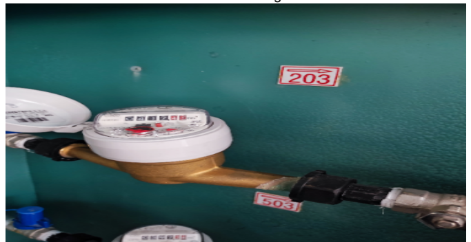
Contador de Agua
