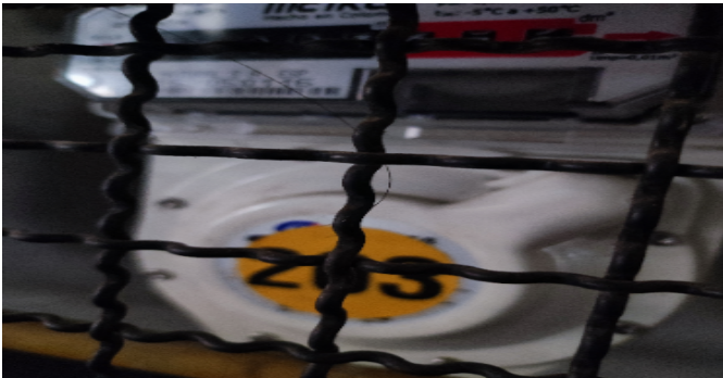
Contador de Gas
