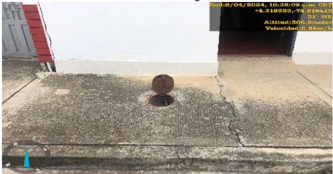
Contador de Agua
