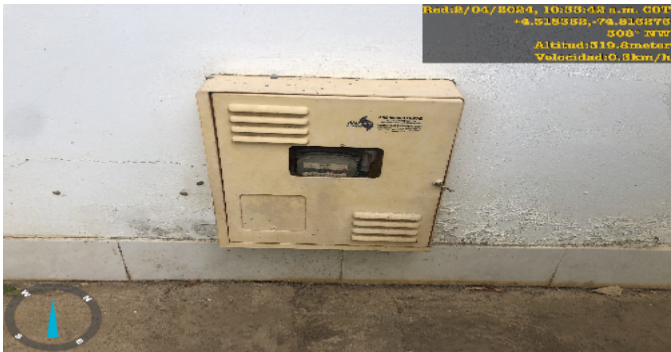
Contador de Gas
