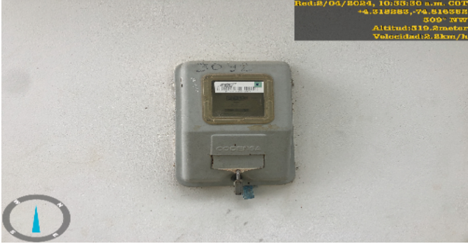
Contador de Energia
