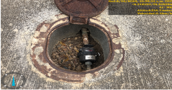
Contador de Agua
