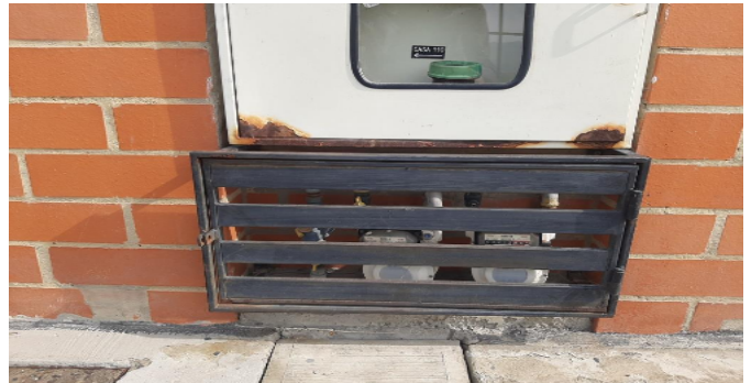
Contador de Gas
