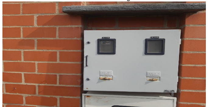
Contador de Energia
