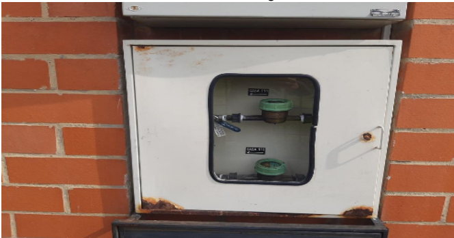
Contador de Agua
