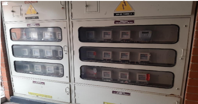
Contador de Energia
