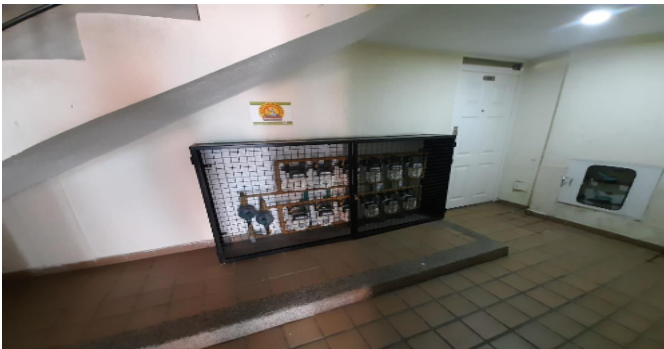
Contador de Gas
