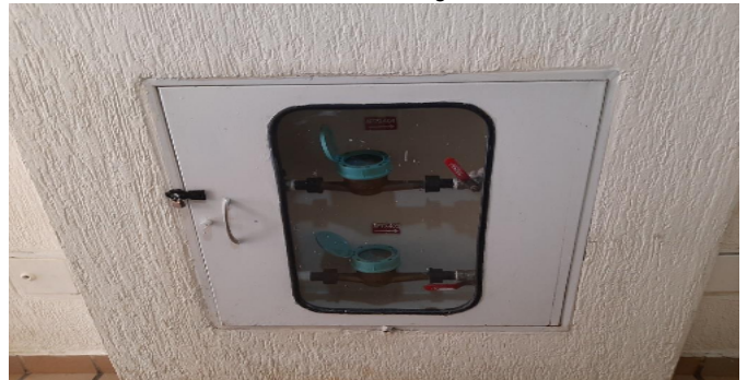
Contador de Agua
