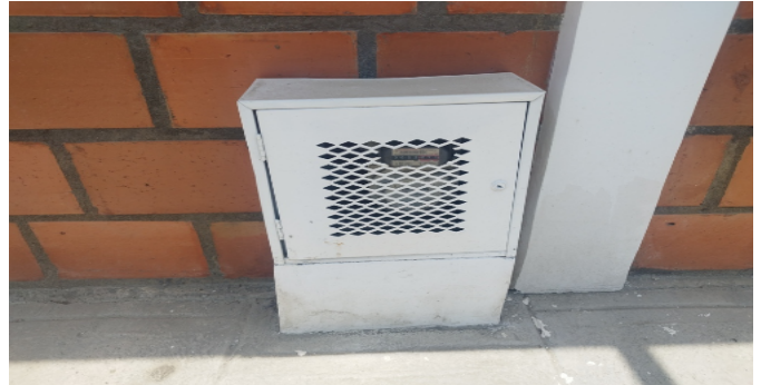
Contador de Gas
