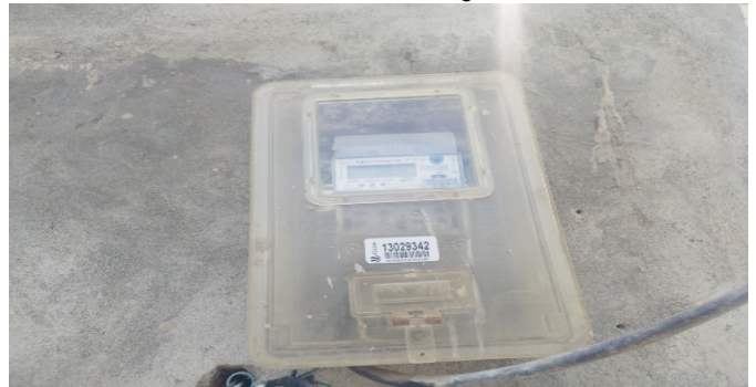
Contador de Energia
