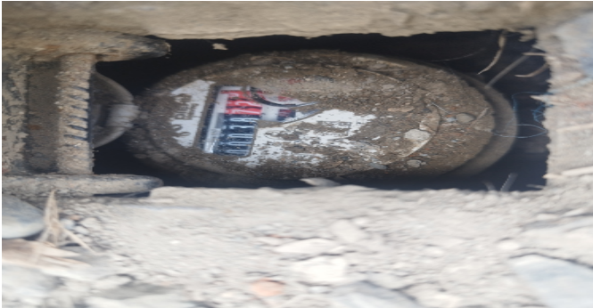
Contador de Agua
