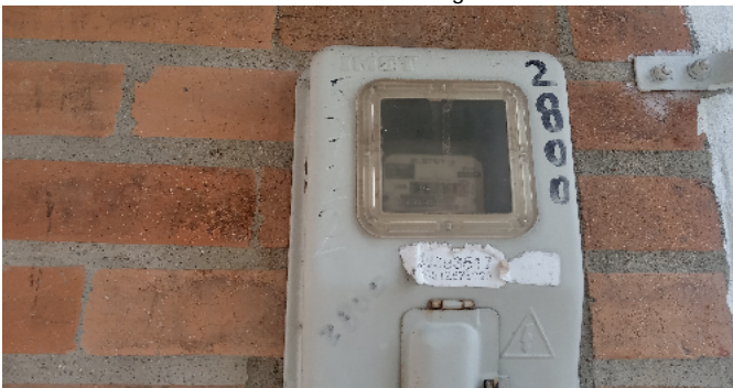
Contador de Energia
