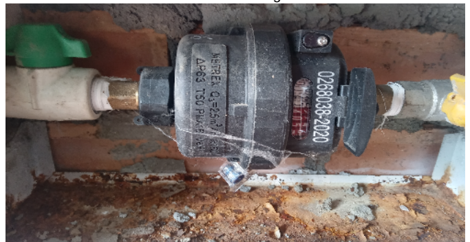
Contador de Agua
