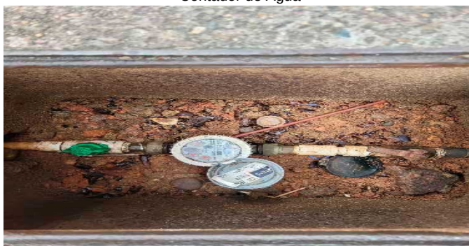
Contador de Agua
