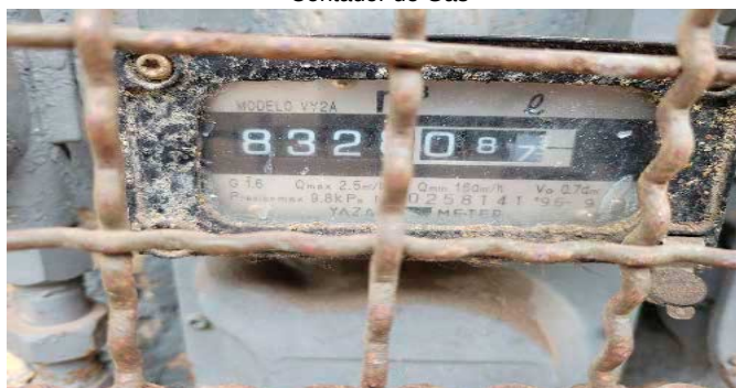
Contador de Gas
