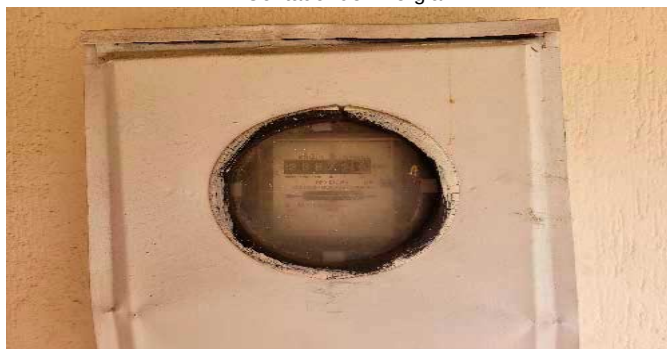
Contador de Energia
