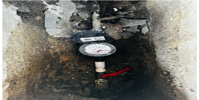
Contador de Agua
