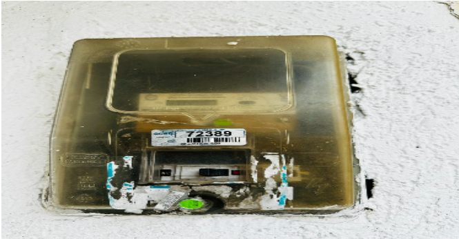
Contador de Energia
