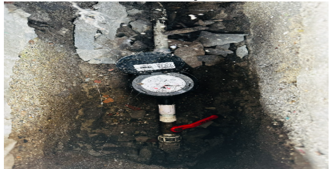
Contador de Agua
