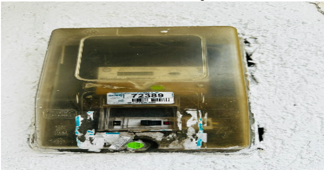
Contador de Energia
