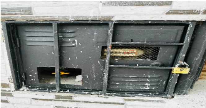
Contador de Gas
