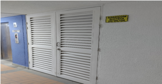
Contador de Energia
