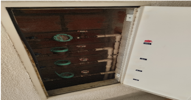
Contador de Agua
