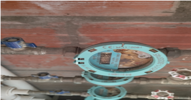
Contador de Agua
