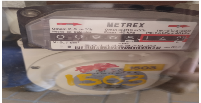
Contador de Gas
