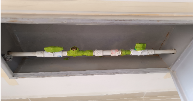
Contador de Agua
