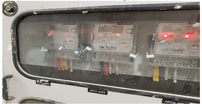
Contador de Energia
