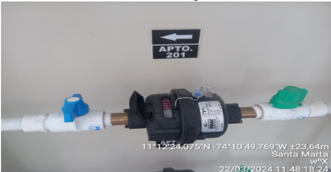
Contador de Agua
