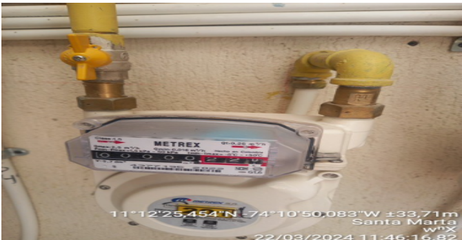
Contador de Gas
