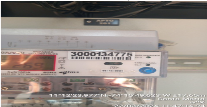
Contador de Energia
