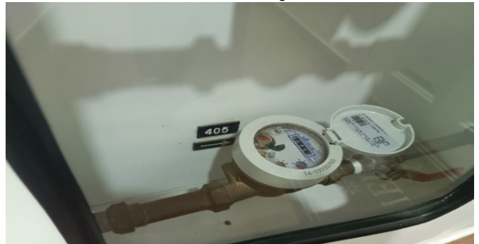
Contador de Agua
