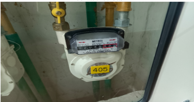
Contador de Gas
