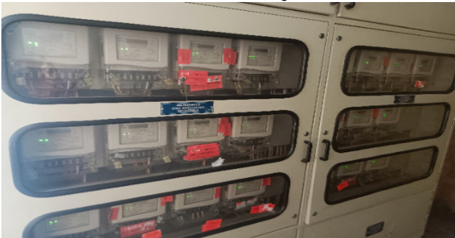
Contador de Energia
