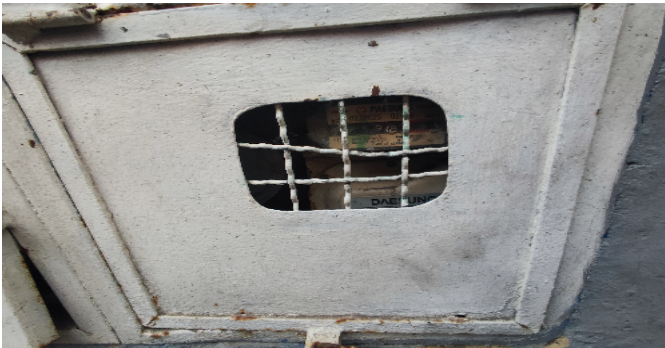
Contador de Gas
