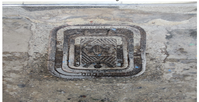
Contador de Agua
