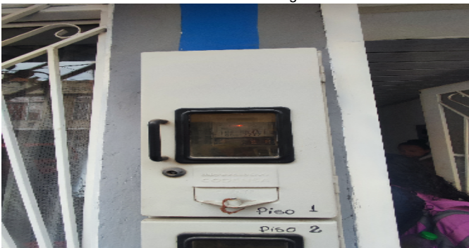
Contador de Energia
