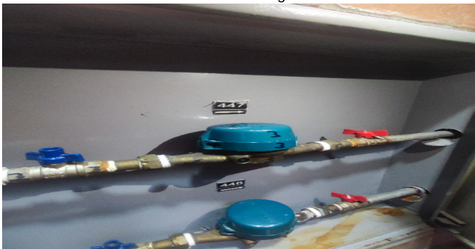
Contador de Agua
