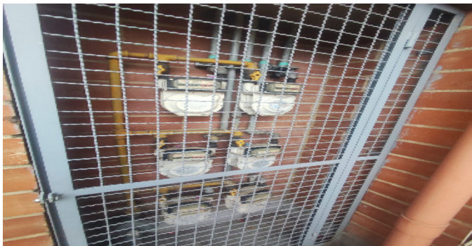
Contador de Gas
