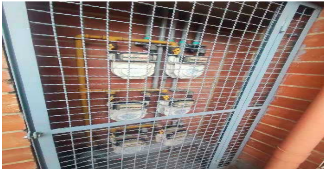
Contador de Gas
