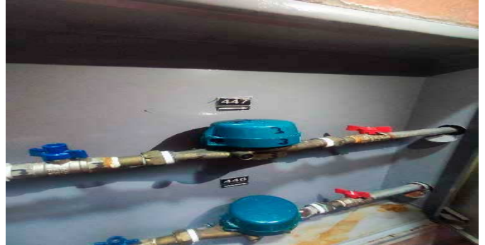
Contador de Agua
