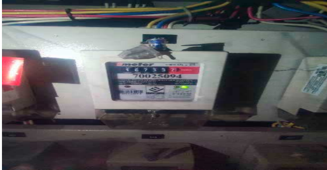
Contador de Energia
