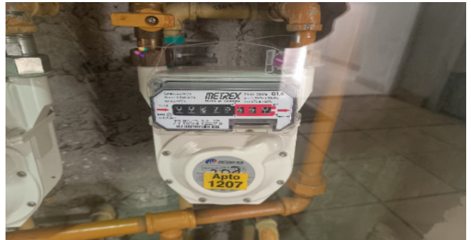
Contador de Gas
