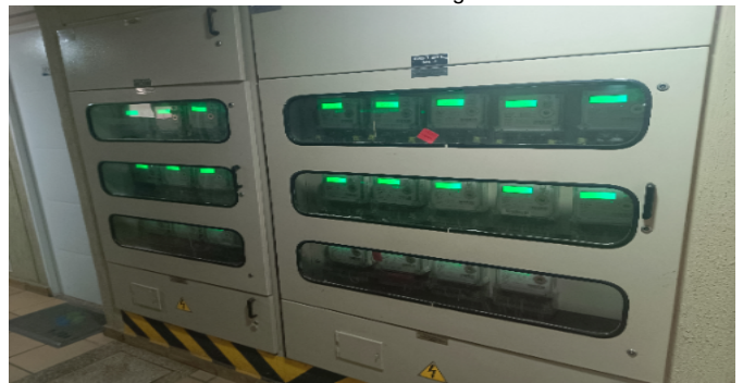
Contador de Energia
