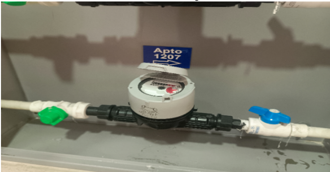
Contador de Agua
