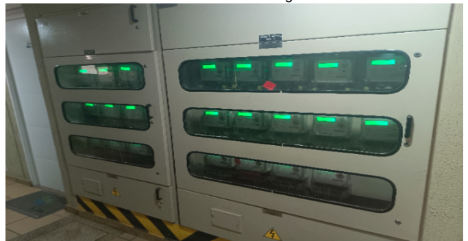
Contador de Energia
