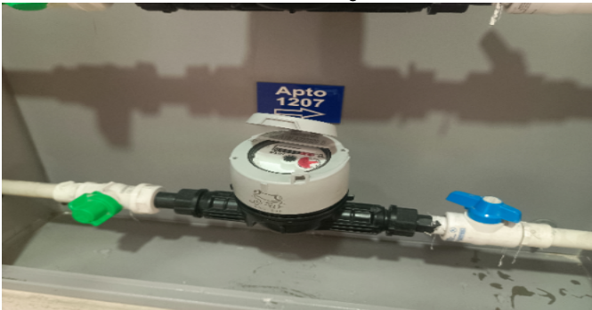
Contador de Agua
