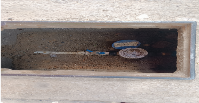
Contador de Agua
