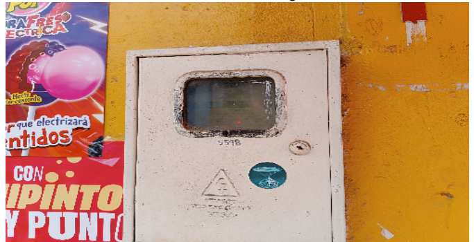
Contador de Energia
