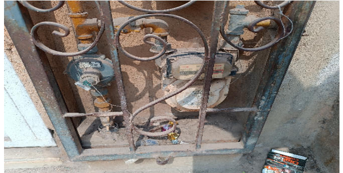
Contador de Gas
