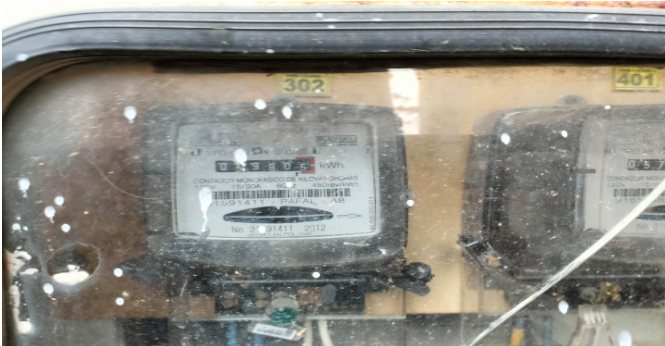
Contador de Energia
