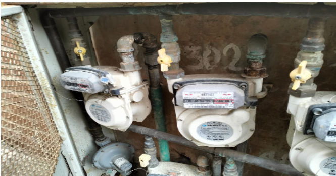
Contador de Gas
