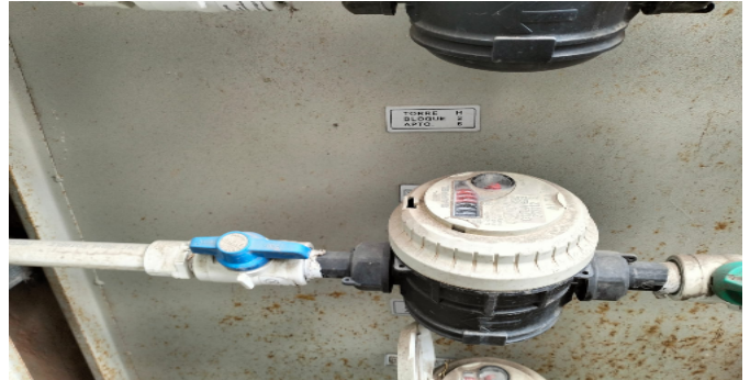
Contador de Agua
