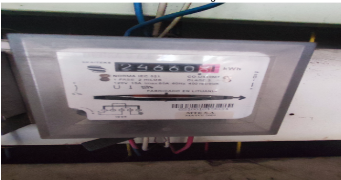
Contador de Energia
