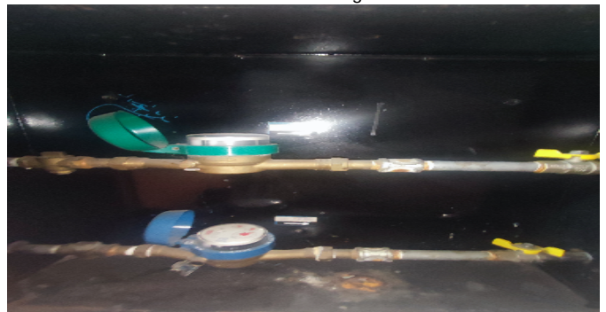
Contador de Agua
