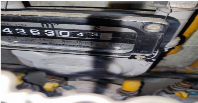
Contador de Gas
