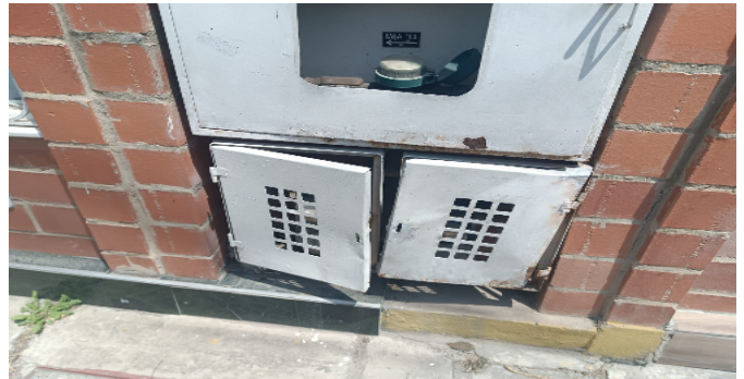
Contador de Gas
