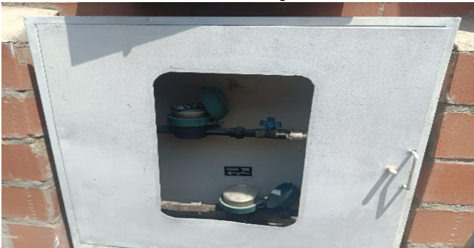
Contador de Agua
