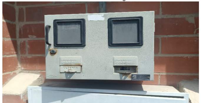
Contador de Energia
