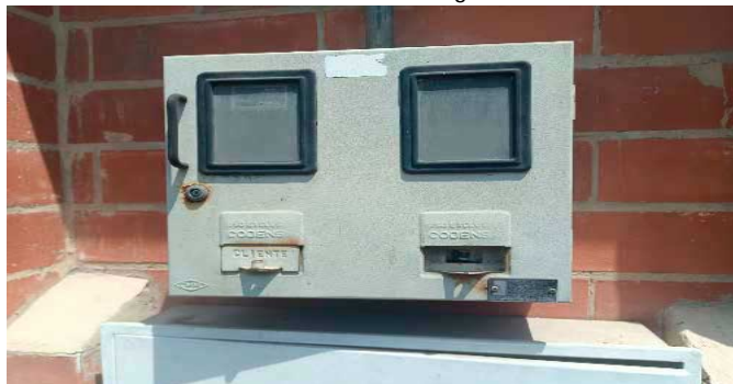
Contador de Energia
