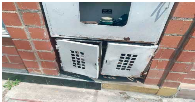
Contador de Gas
