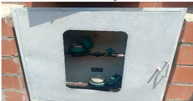
Contador de Agua
