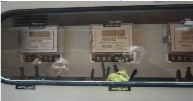
Contador de Energia
