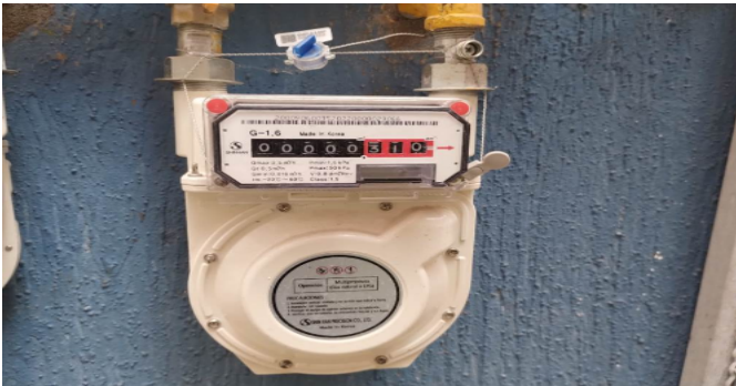
Contador de Gas
