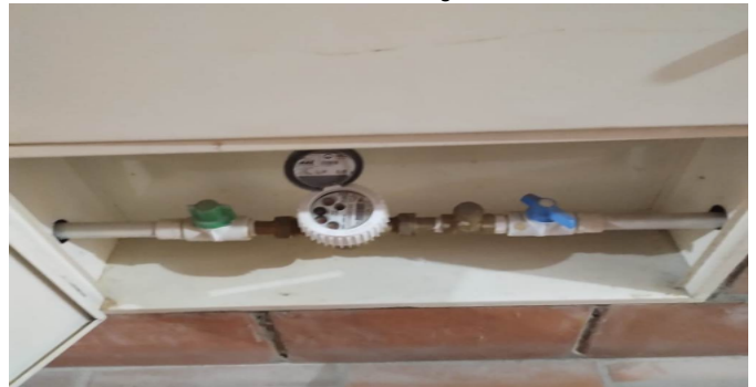
Contador de Agua
