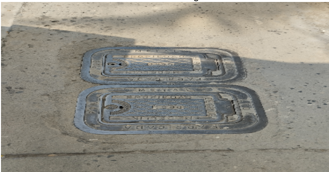
Contador de Agua
