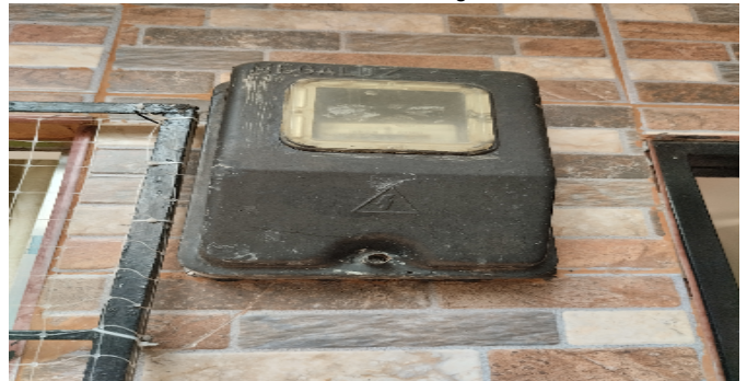
Contador de Energia
