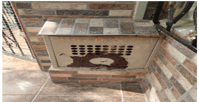
Contador de Gas
