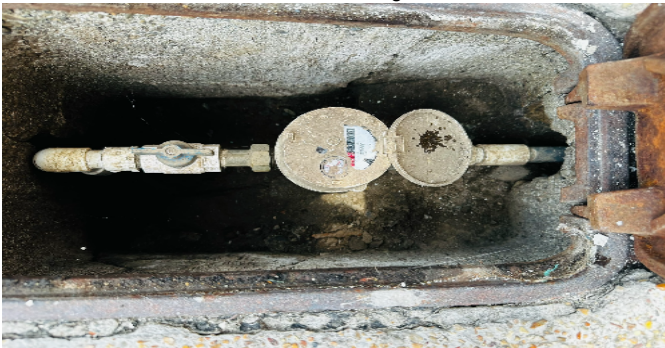
Contador de Agua
