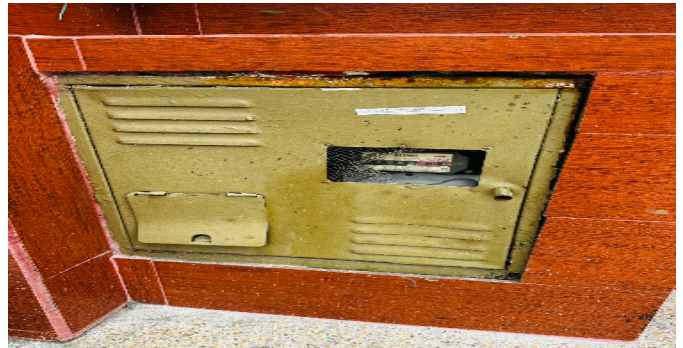
Contador de Gas
