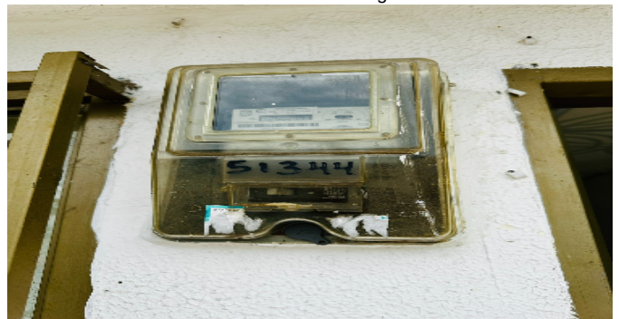
Contador de Energia
