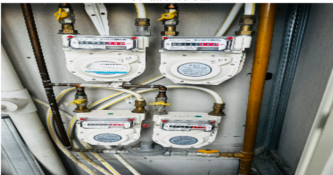
Contador de Gas
