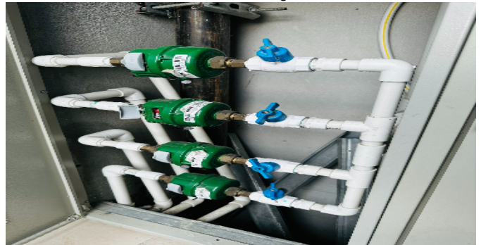
Contador de Agua
