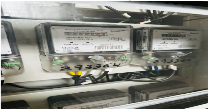
Contador de Energia
