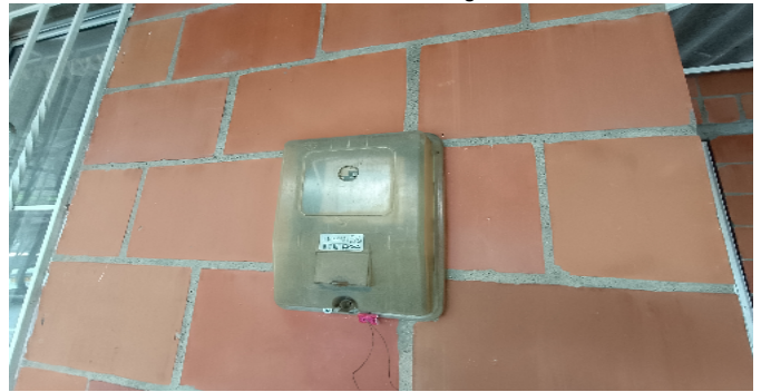
Contador de Energia
