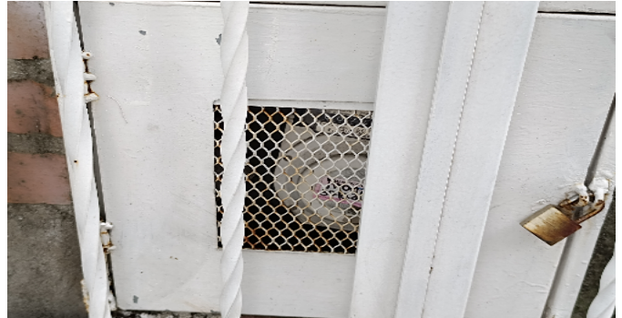
Contador de Gas
