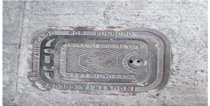
Contador de Agua
