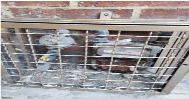
Contador de Gas
