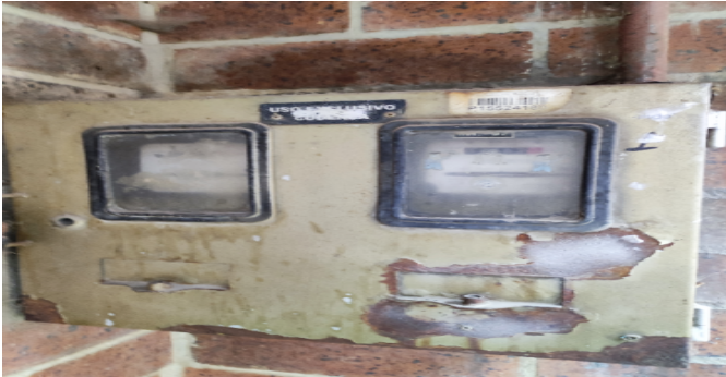
Contador de Energia
