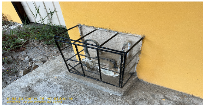
Contador de Gas
