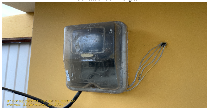
Contador de Energia
