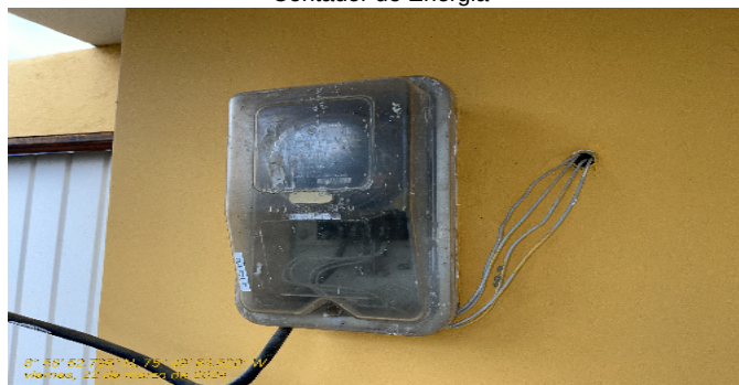
Contador de Energia
