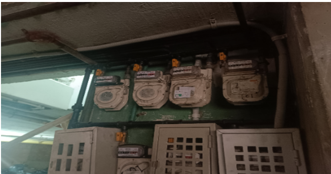
Contador de Gas
