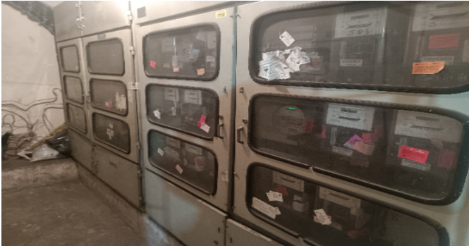
Contador de Energia
