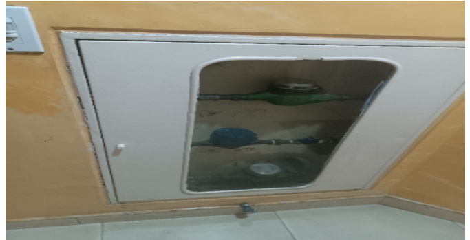
Contador de Agua
