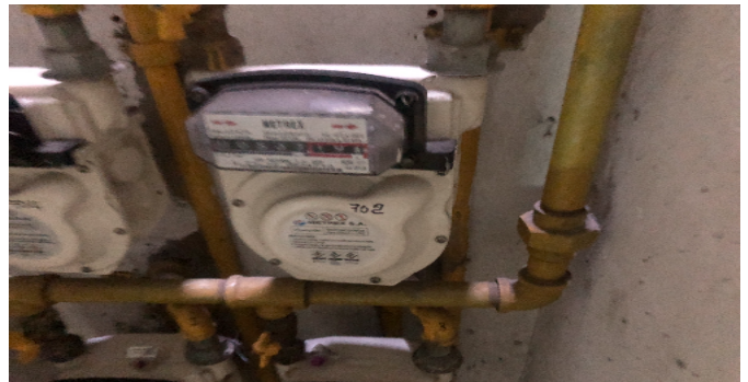
Contador de Gas
