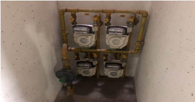
Contador de Gas
