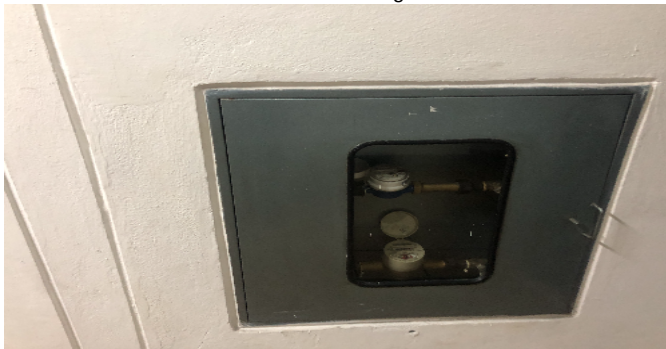
Contador de Agua
