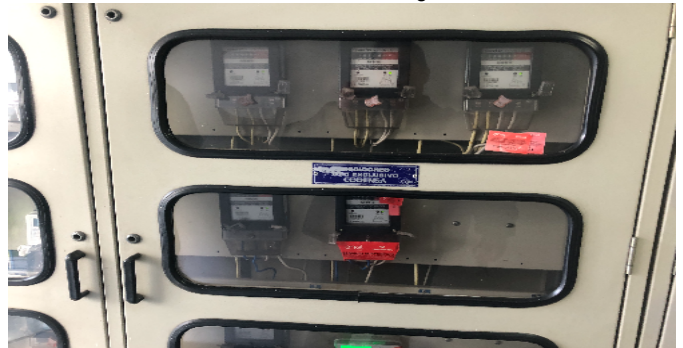
Contador de Energia
