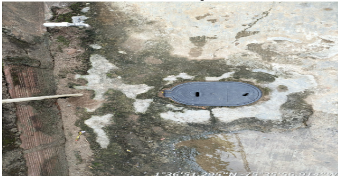
Contador de Agua
