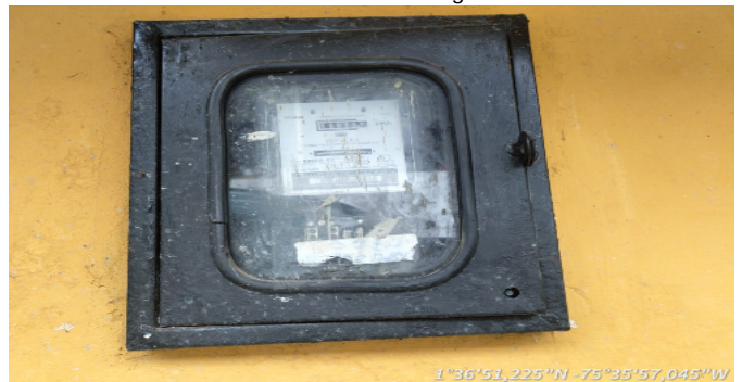
Contador de Energia
