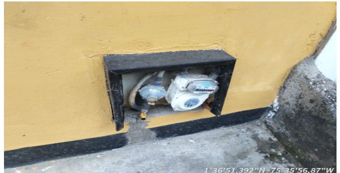
Contador de Gas
