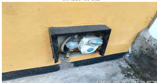
Contador de Gas
