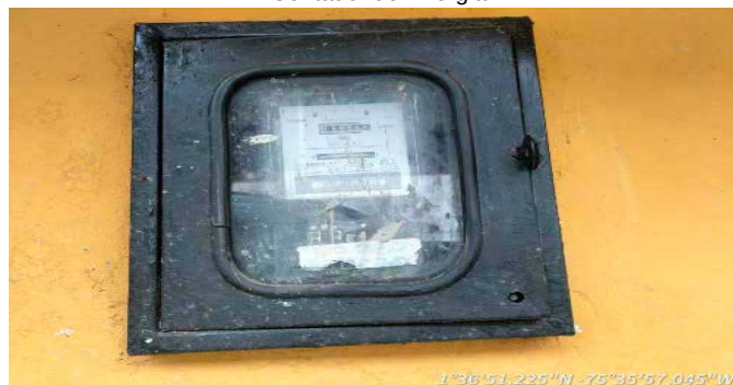
Contador de Energia
