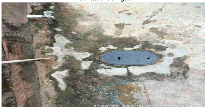
Contador de Agua
