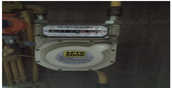
Contador de Gas
