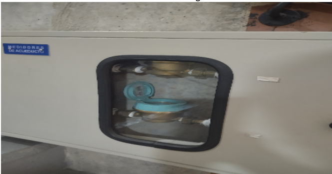
Contador de Agua
