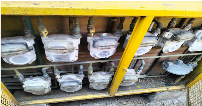
Contador de Gas
