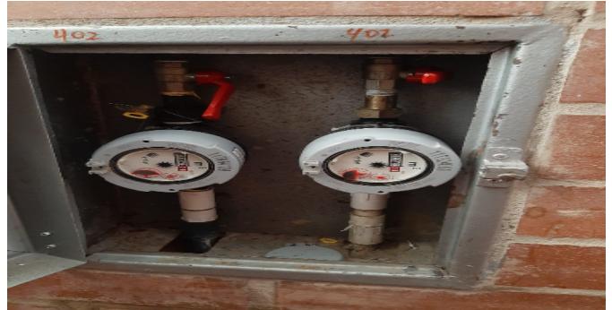
Contador de Agua
