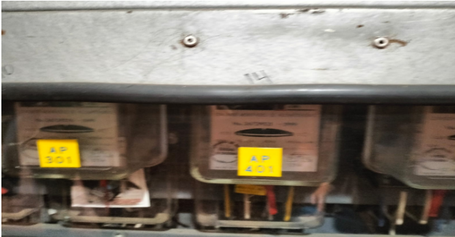
Contador de Energia
