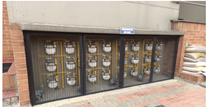
Contador de Gas
