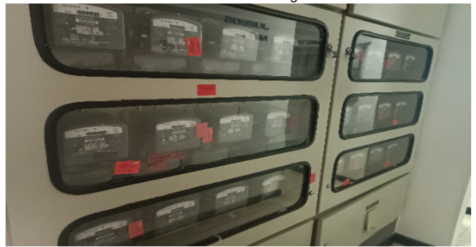
Contador de Energia
