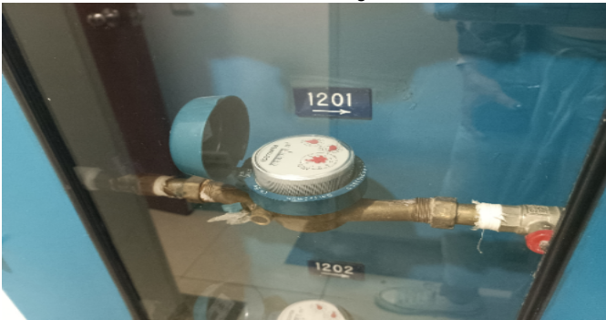
Contador de Agua
