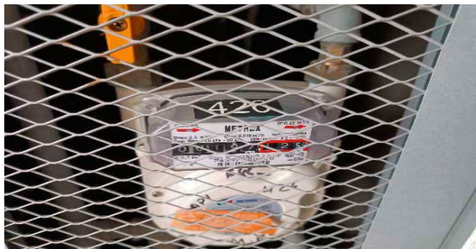
Contador de Gas
