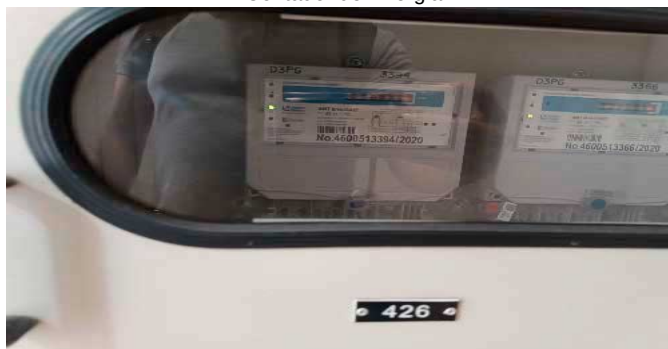
Contador de Energia
