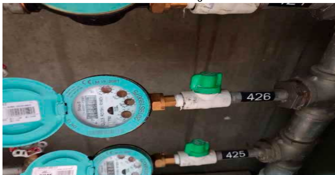
Contador de Agua
